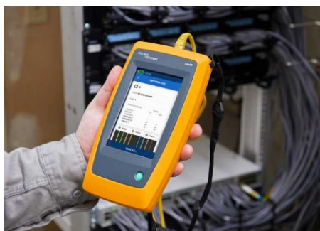
写真 5-6 LinkIQ™ ケーブル+ネットワーク・テスター
